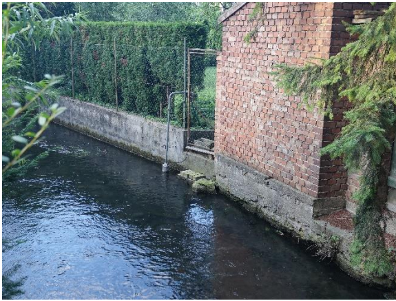
Abbildung 142. Kalter Gang in Himberg, Flkm 8,2 (09.07.2024). Kastenprofil, nicht bewilligte Pumpe.
