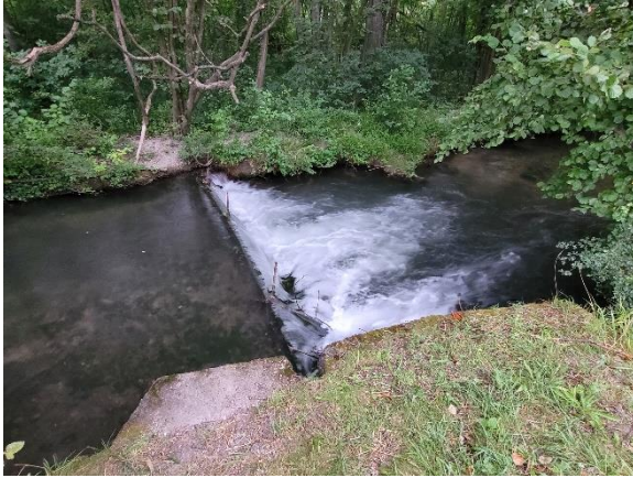
Abbildung 127. Nicht passierbarer Sohlabsturz am Kalten Gang Höhe Velm, Flkm 13,64 (07.07.2024). Im Bildvordergrund Beton-Ausleitungsbauwerk.
