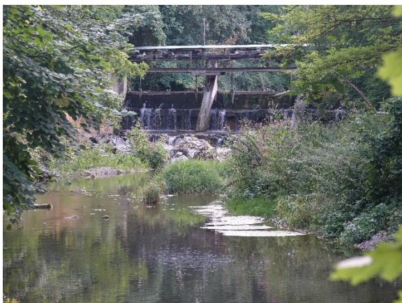
Abbildung 34. Wehranlage an der Triesting Höhe Flkm 21,84 zur Ausleitung des Werkskanals Günselsdorf bis Tattendorf. Undichtheiten ca. 20 L/s (09.08.2024)
