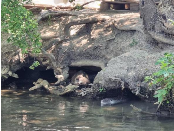
Abbildung 18. Beispiel der zahlreichen Unterspülungen von Ufern am Kalten Gang (hier Himberg stromab ARA) durch Nutria.
