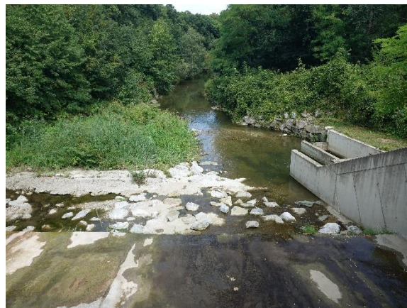
Abbildung 49. Wehranlage mit Schnecke als FAH in der Restwasserstrecke der Triesting Höhe 17,88 (19.08.2024).
