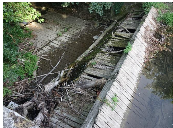
Abbildung 41. Desolate Wehranlage bei der Überleitung vom Werkskanal zur Triesting (Höhe Flkm 20,8) in Günselsdorf ca. 100 m unterhalb der B17 (09.08.2024).
