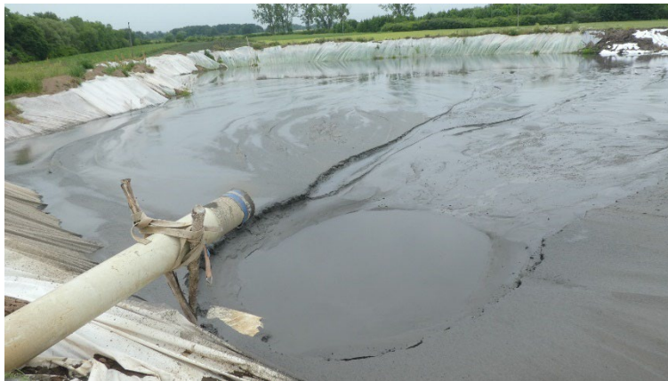
Abbildung 19: Einlaufbereich der Teichanlage zum Absetzen und zur solaren Trocknung beim Projekt Zwerndorf der Schlammsaug GmbH
