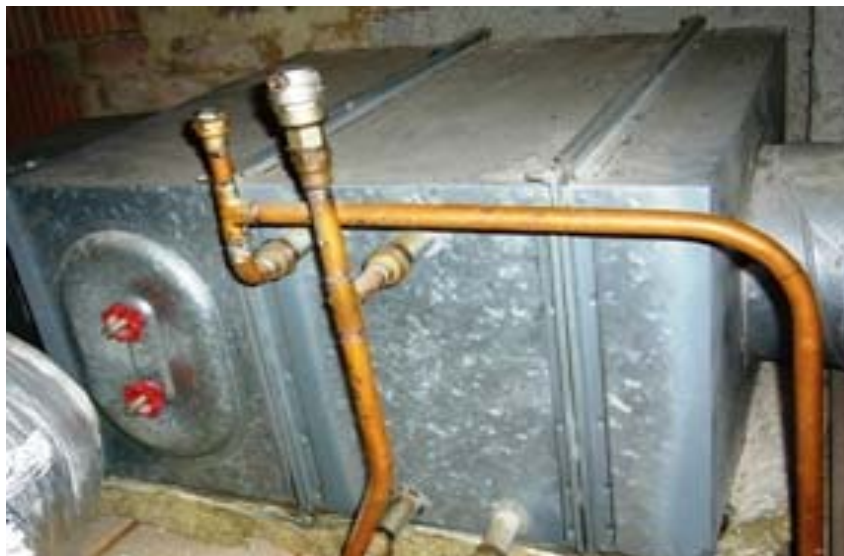
Abbildung 19: Wärmetauscher zur Warmwassererzeugung im Sommer
