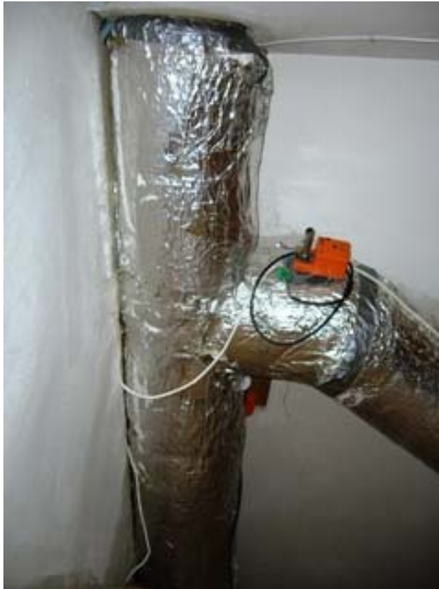
Abbildung 4: Kollektorrücklauf Durchführung, rechts Abzweigung zum Sommer-By-Pass
