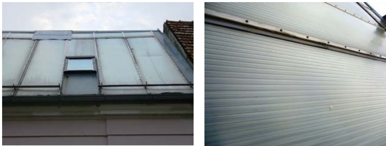
Abbildung 6: Details am Solardach, und Schäden nach 5 Jahren Betrieb aufgrund mangelhafter Ausführung.
