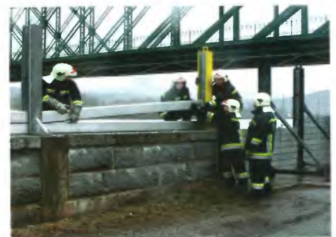
Mobiler Hochwasserschutz Donau / Krems – Stein
