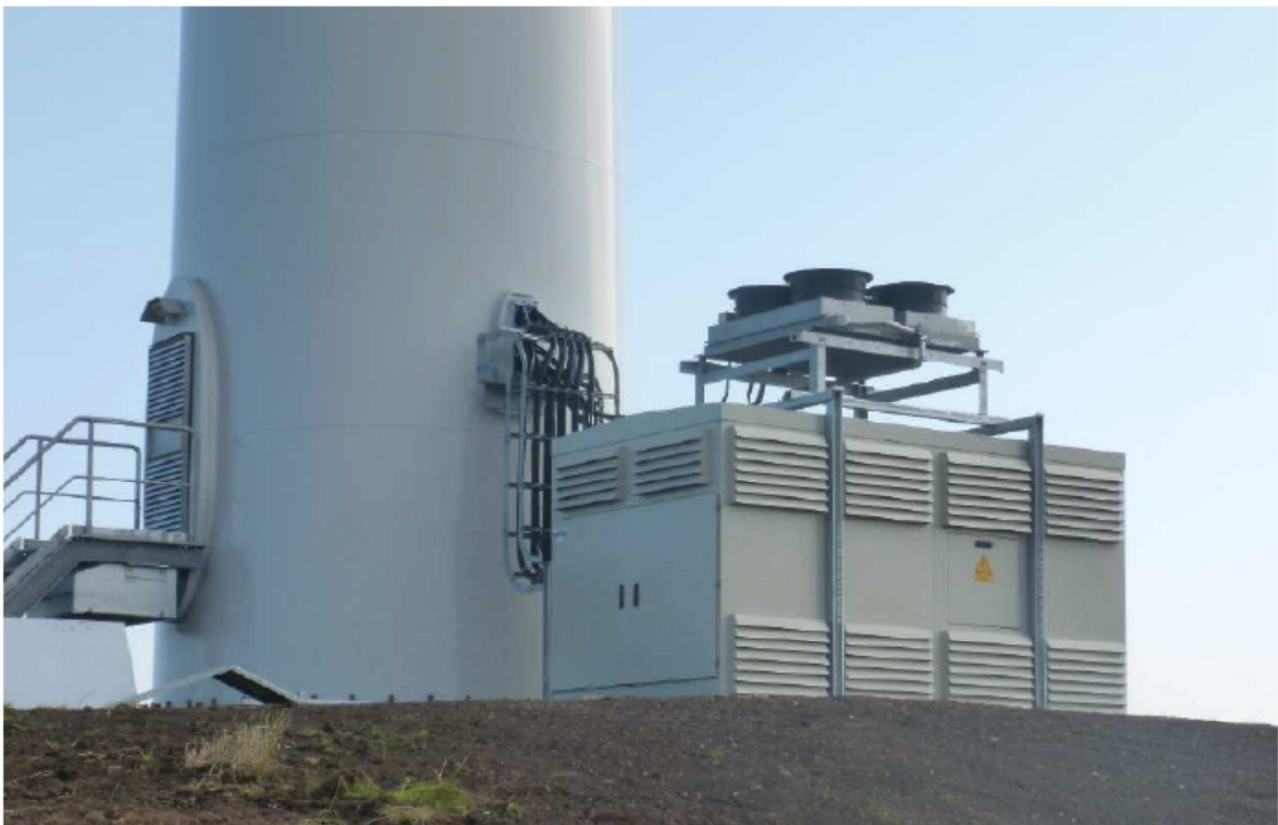
Abbildung 1: Abbildung einer Externen Trafo Station einer Senvion 3.4 M122 mit Stahlrohrturm in Deutschland
