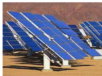
Bild 20 Sonnenkollektoren in Herzogenburg
