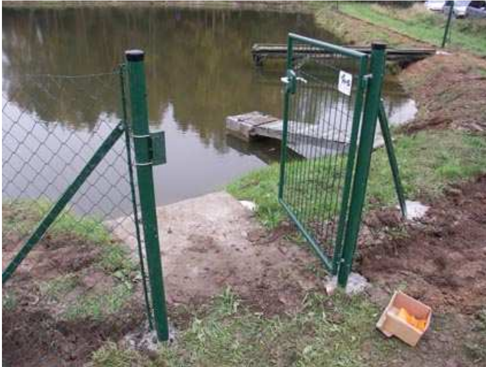
Abb. 5: Die gebohrten Löcher werden mit Beton ausgefüllt um die Eckspannsäulen, die Mittelspannsäulen und die seitlichen Stützstreben für die Zaunspannung zu stabilisieren.
